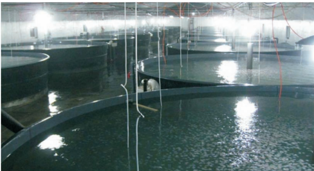
图3 鲆鲽类循环水养殖车间
